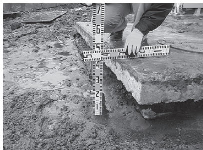
写真－1 液状化による浄化槽の浮上
