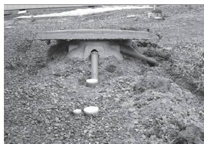
写真－2 浄化槽・管きよの浮上
