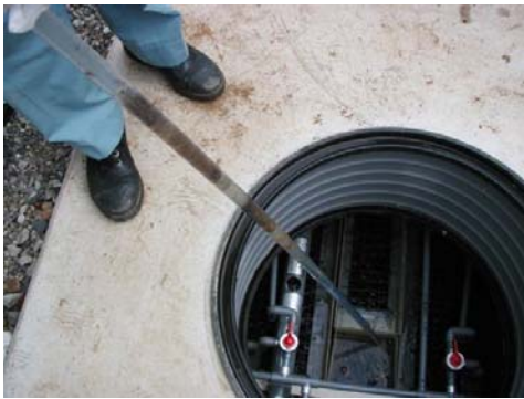
汚泥堆積状況の確認
